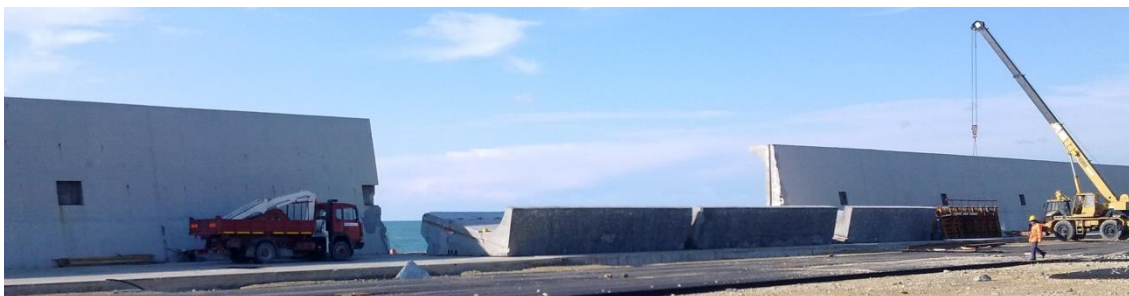
Figura 4: Crollo del dicembre 2011 - Muro paraonde sul cassone n.7
