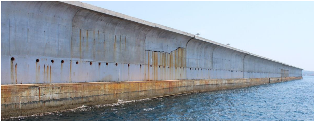
Figura 6: Fessurazione maggio 2015 – Concio n.1 del cassone 10
