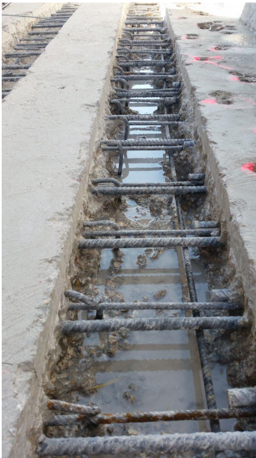
Figura 3 – Rimozione del calcestruzzo costituente la parte di copriferro della struttura a cui andranno collegate le nuove strutture
