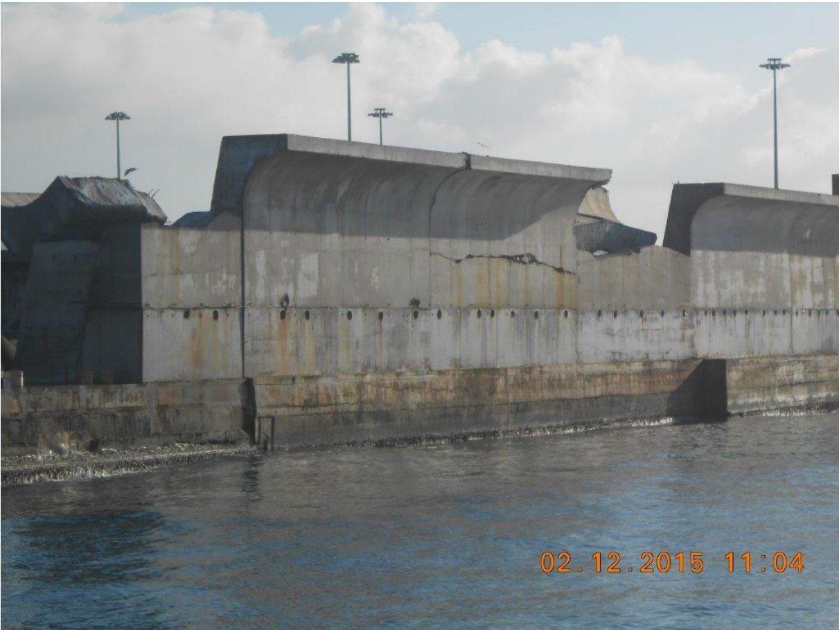
Figura 2 – Danni provocati dalla mareggiata del novembre 2015
